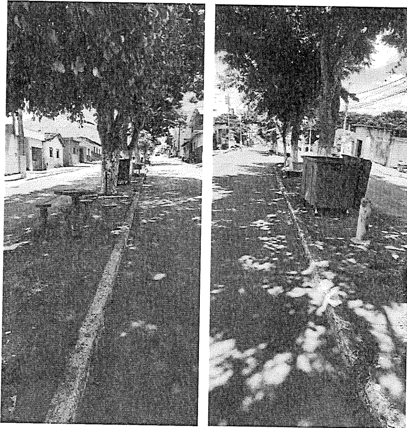
Foto 02: Jardim centra na avenida Jair Leite - Local da regularização do meio fio e instalação Pavimento Intertravado.
